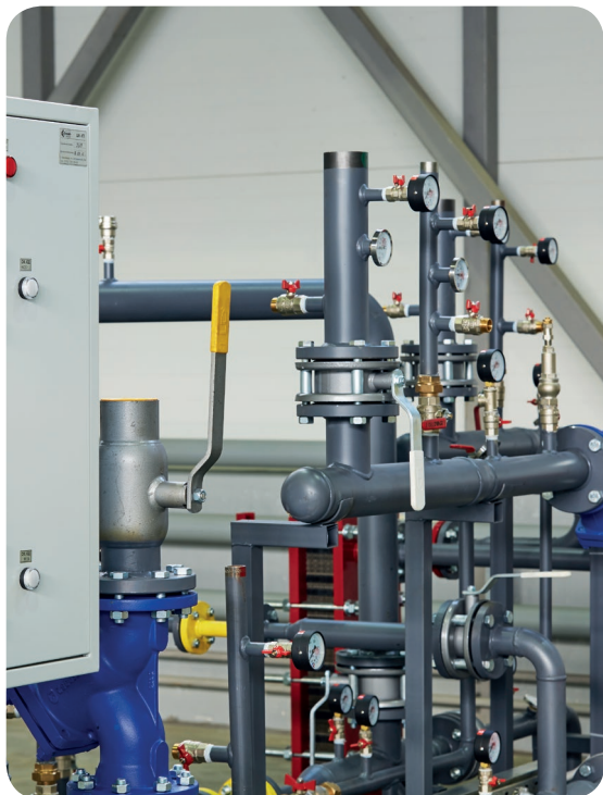
ИНДИВИДУАЛЬНЫЙ ТЕПЛОВОЙ ПУНКТ
