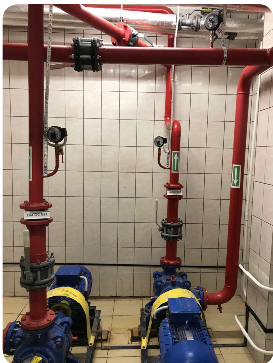
ИНДИВИДУАЛЬНЫЙ ТЕПЛОВОЙ ПУНКТ
